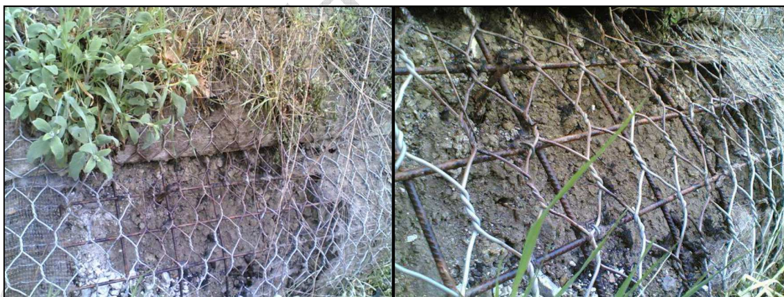
Fig. 43 – Perdita di materiale fine a causa di incendio e conseguente danneggiamento del ritentore di fine. Il terreno vegetale dietro al paramento rimane esposto.
