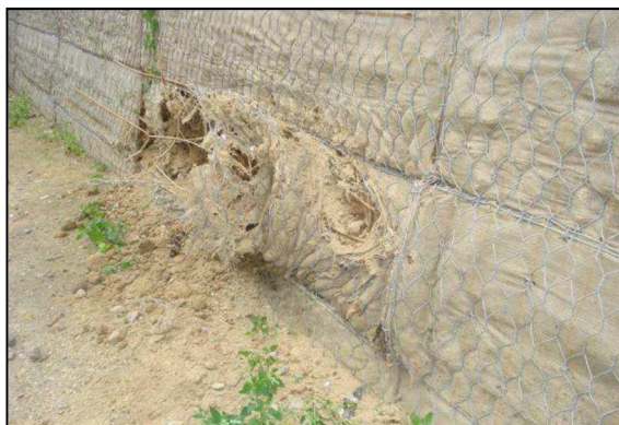
Fig. 42 – Svuotamento del riempimento vegetale dovuto ad un urto sul paramento
