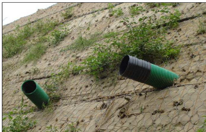
Fig. 34 – Tubi di piccolo diametro che attraversano TMV
